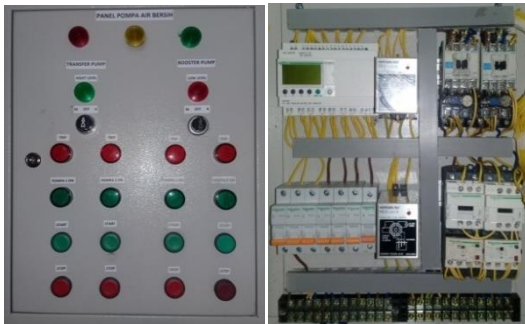
Gambar 7. Panel kendali Pompa Air Bersih Gedung Bertingkat
